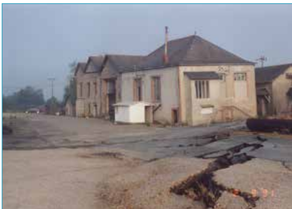
Illustration 1.26 : Mise en pente d'un bâtiment à la suite d'un affaissement, La Pouëze (49) [crédit INERIS, sd]
