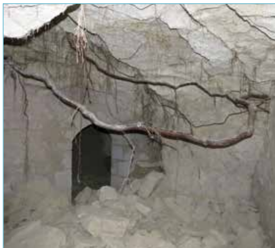
Illustration 1.9 : Effets de la végétation racinaire sur un toit de cavité souterraine, Vernioil (49) [crédit Cerema Ouest, 2013]
