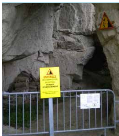
Illustration 3.9 : Zone sous-cavée interdite d'accès (affiche d'information à gauche et arrêté municipal à droite), Montsoreau (49) [crédit Cerema Centre-Est, 2013]
