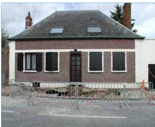
Illustration 1.17 : Fontis apparu sous une maison d'habitation, Esquennoy (60) [crédit INERIS, sd]
