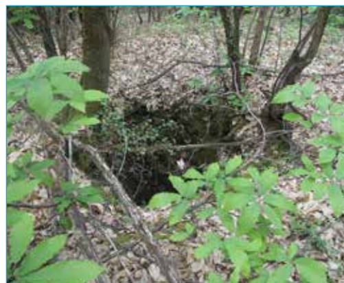
Illustration 1.25 : Puits d'aération d'une carrière souterraine, non protégé et non signalé, Louerré (49) [crédit Cerema Ouest, 2010]
